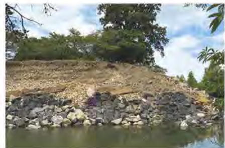
大きく崩落した八代城跡の三階櫓跡の石垣。石材の一部は水堀の中に沈んでしまっている。
