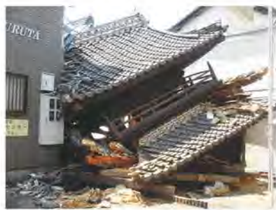
震度6強の揺れで倒壊した市指定文化財の安養寺(本町3丁目)の楼門。
