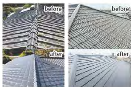
▲屋根や外壁の損傷など、まずはご相談を！ 早ければ1週間で着工・発注から2カ月で多数の工事完了実績
