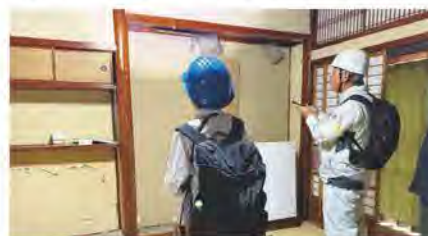
木造三階建ての貴重な鏡屋旅館。客室の壁の剥がれや浴場の破損のため、カフェと併せて休業中。
